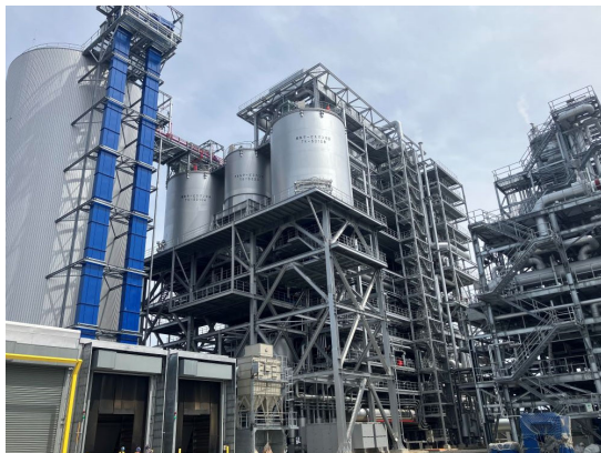
発電所敷地内（燃料タンク：写真左） での保管状況
